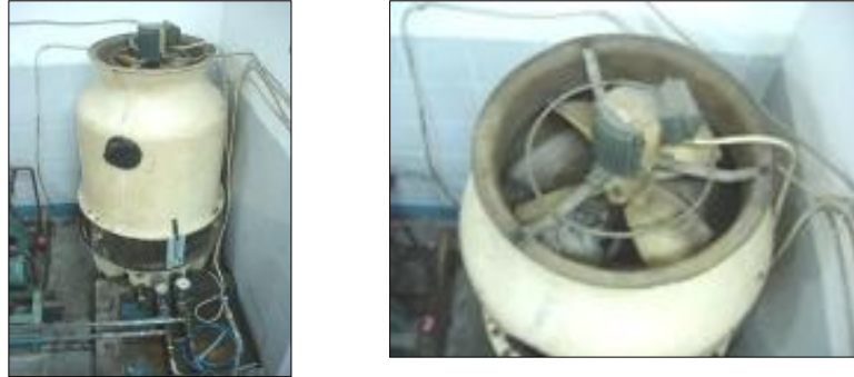
Gambar 1. Menara Pendingin lengkap dengan Fan dan Spray Nozzle
